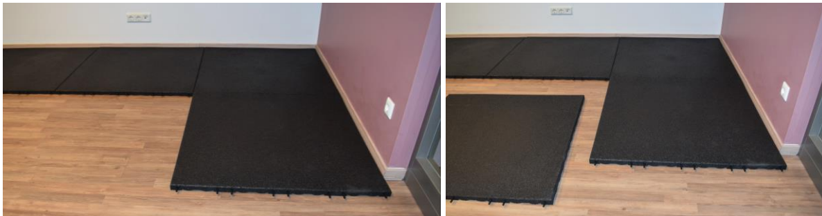
Die zweite Reihe mit den Platten genauso beginnen und fortfahren; Platte neben Platte legen
