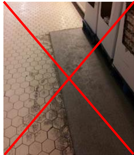
nicht geeigneter Bodenbelag
