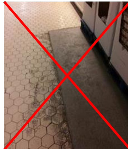
nicht geeigneter Bodenbelag
