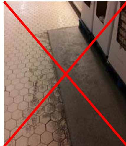
nicht geeigneter Bodenbelag
