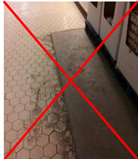
revêtement de sol inadapté
