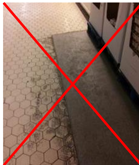
revêtement de sol inadapté
