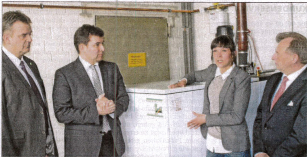
Georg Stockhammer (r.), André Rummel (IHK Salzwedel; l.) und Thomas Bräuer (Stadtwerke Stendal) ließen sich von Tony Brockmann (Abrotec) die neue Heizzentrale erklären. Foto: Röhl
